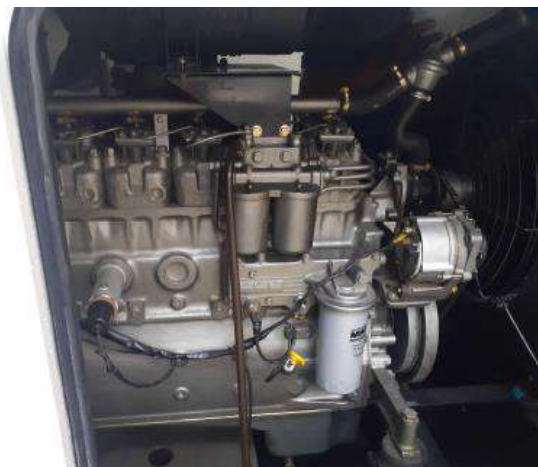
Figura 88: Gerador do Auditório
